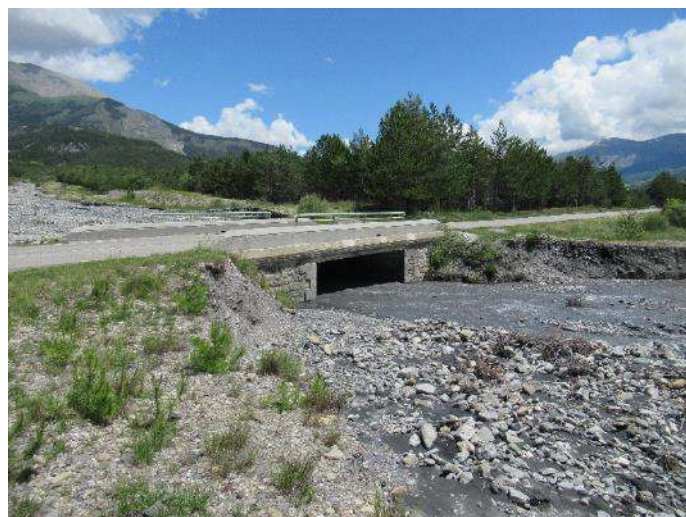
Figure 30 : Banc de gravier végétalisé
