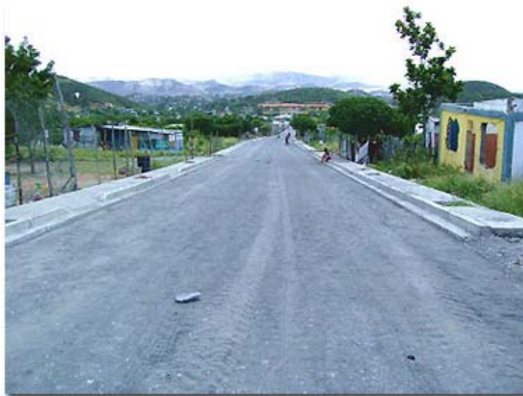
Esta calle en el sector Los Pocitos fue parcialmente asfaltada por la Alcaldía pero fue paralizado por la Superintendencia
