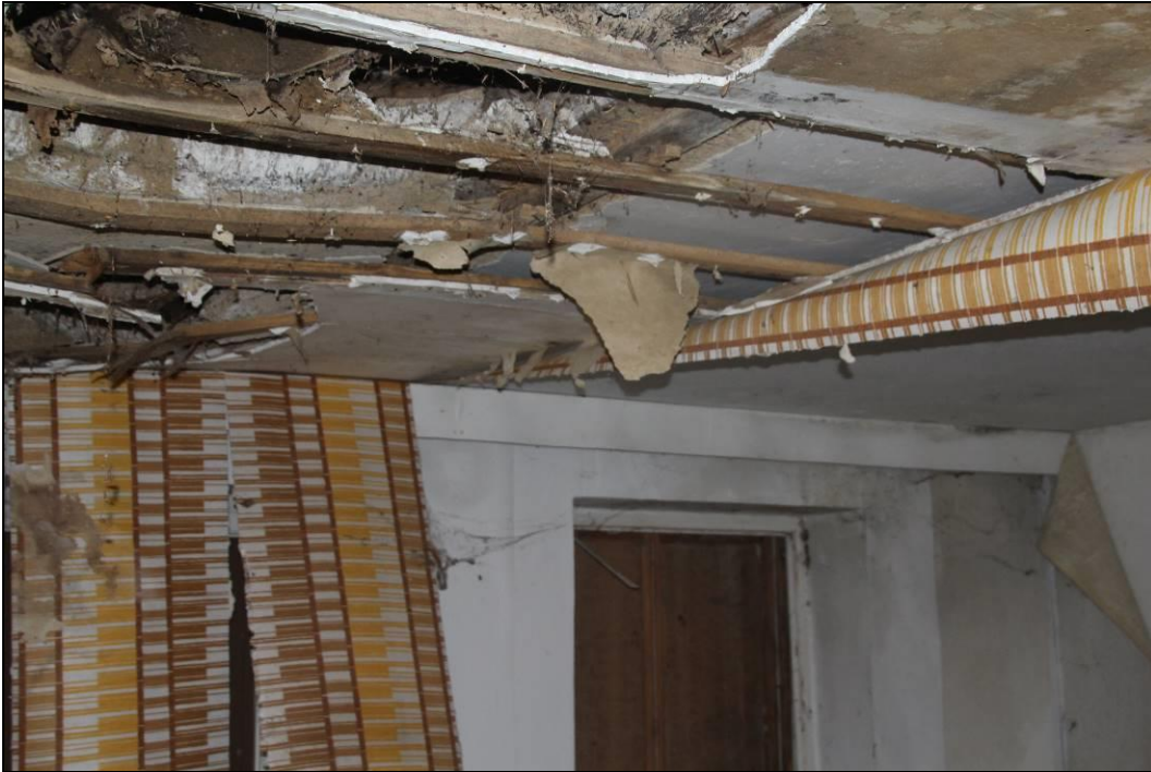
Abbildung 8: Innenraum mit eingestürzter Decke im Erdgeschoss
