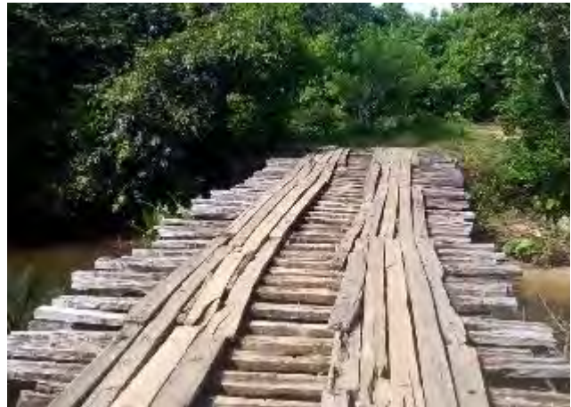
Figure 5. Pont à remplacer
