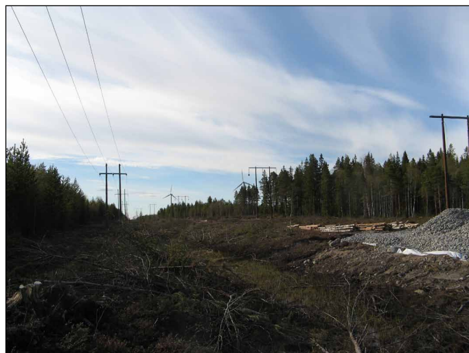
Breddning av kraftledningsgata på Pitholmen inför anslutningen av vindkraftverken på Bondön 2008 (foto: Kerstin Boström, ÅF).
