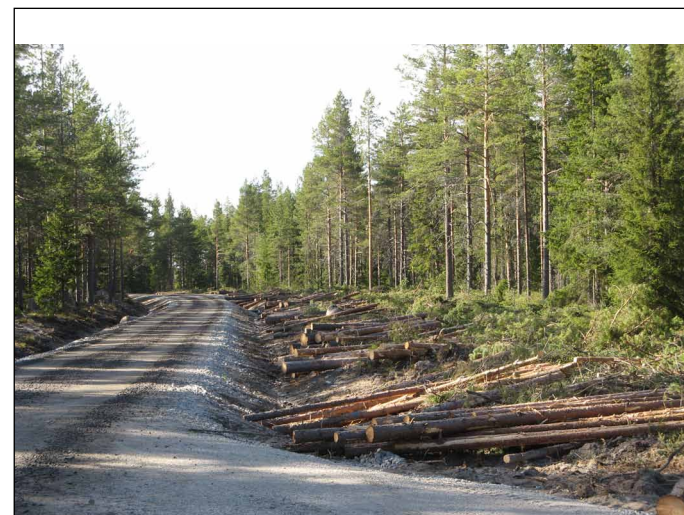
Förberedande avverkning inför kabelförläggning i mark längs vägen på Bondön (foto: Kerstin Boström, ÅF).
