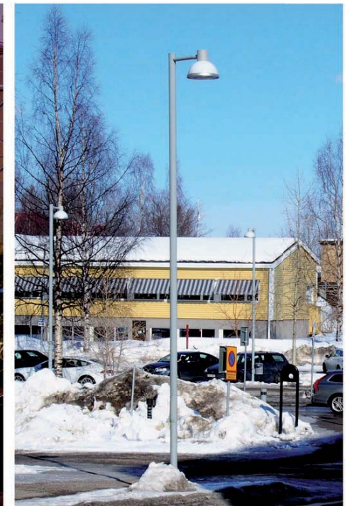
Befintlig rakstolpe "icon" på Håggholmen.
