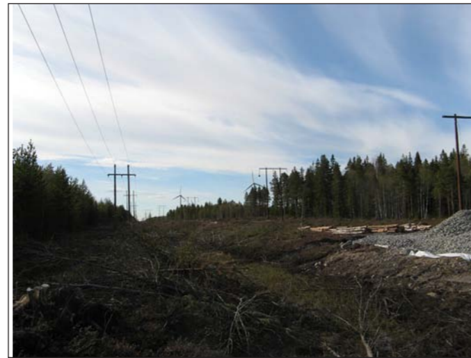
Breddning av kraftledningsgata på Pitholmen inför anslutningen av vindkraftverken på Bondön 2008 (foto: Kerstin Boström, ÅF).
