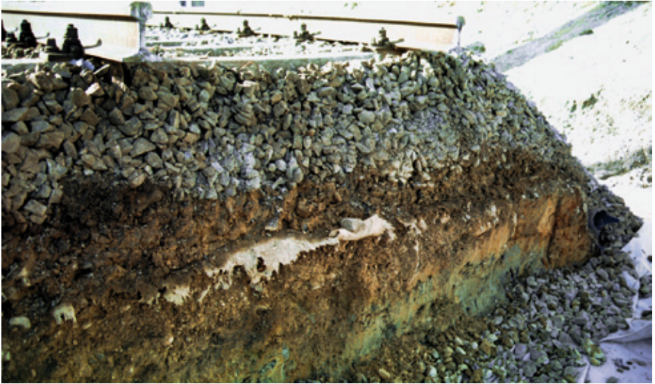
Abb. 7: Zustand des Schichtsystems mit Vliesstoff oben beim Ausbau nach 27 Jahren
