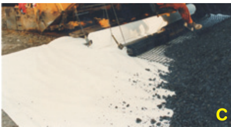
Abb. 12: Einbauvarianten mit Geokunststoffen A - Vliesstoffe überlappend verlegt, B - Vliesstoff mit im Druckbereich verlegtem Geogitter, C - Vliesstoffe überlappend bis zum Randweg mit Geogitter
