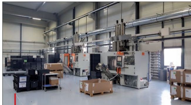
Presses Maplan installées dans la nouvelle usine de Tigery.
