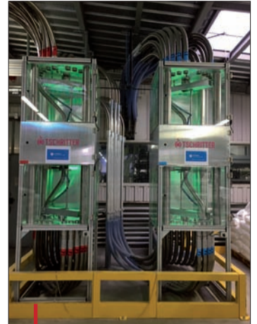
L'installation d'alimentation robotisée en granulé travaille avec deux centrales de vide.
