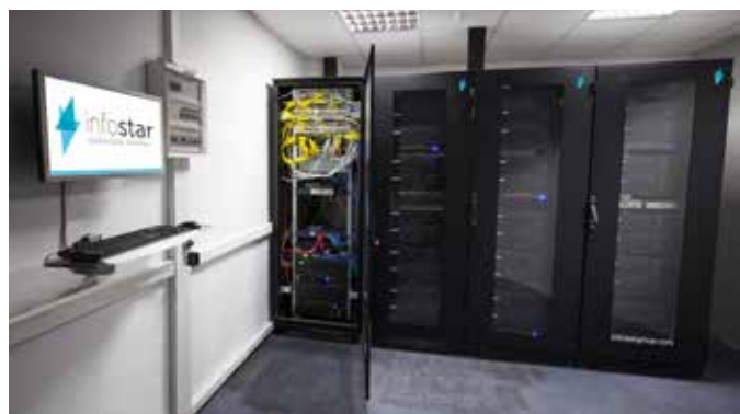
Il data center di Infostar
