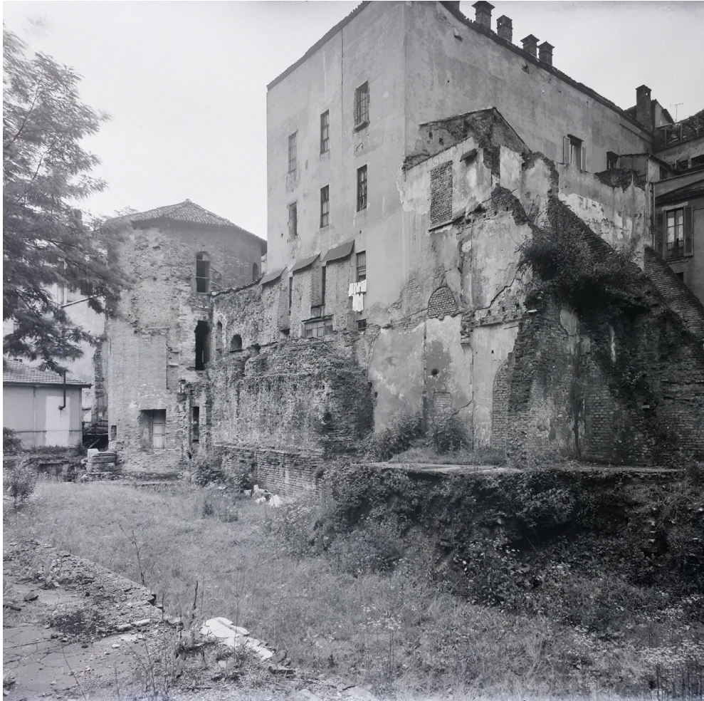
I lavori di liberazione della torre poligonale e delle mura. Si veda nel registro, a p. 170, IM_foto_SD_Torre poligonale.
