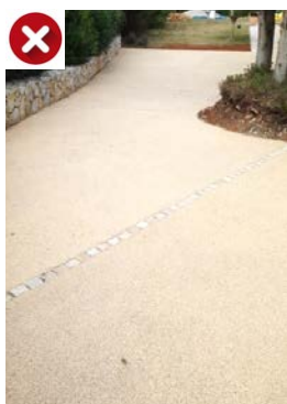
Béton trop clair
