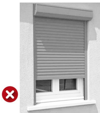
Les volets roulants et caissons apparents en PVC
