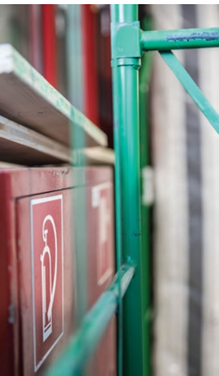
Zugang versperrt, Türe defekt: im Brandfall ein Desaster
