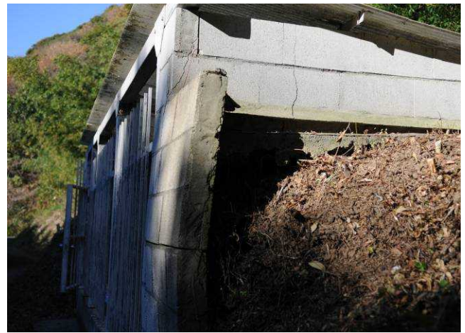
写真12 せり出したブロック
