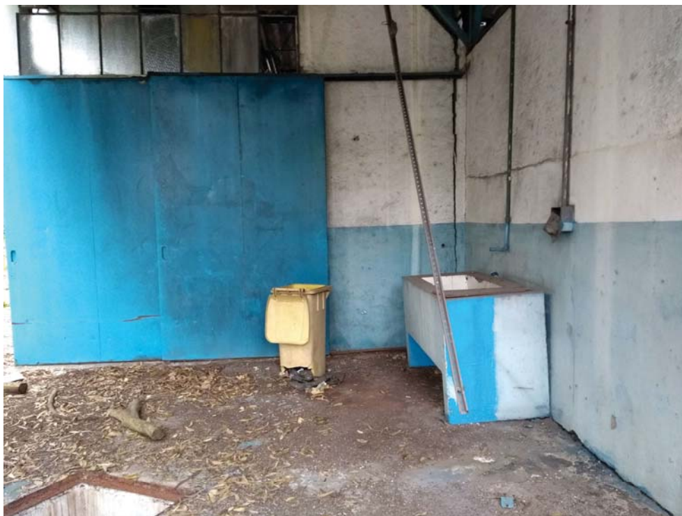
Foto 25 – Tanque localizado ao lado da área de jateamento (AF-08).
