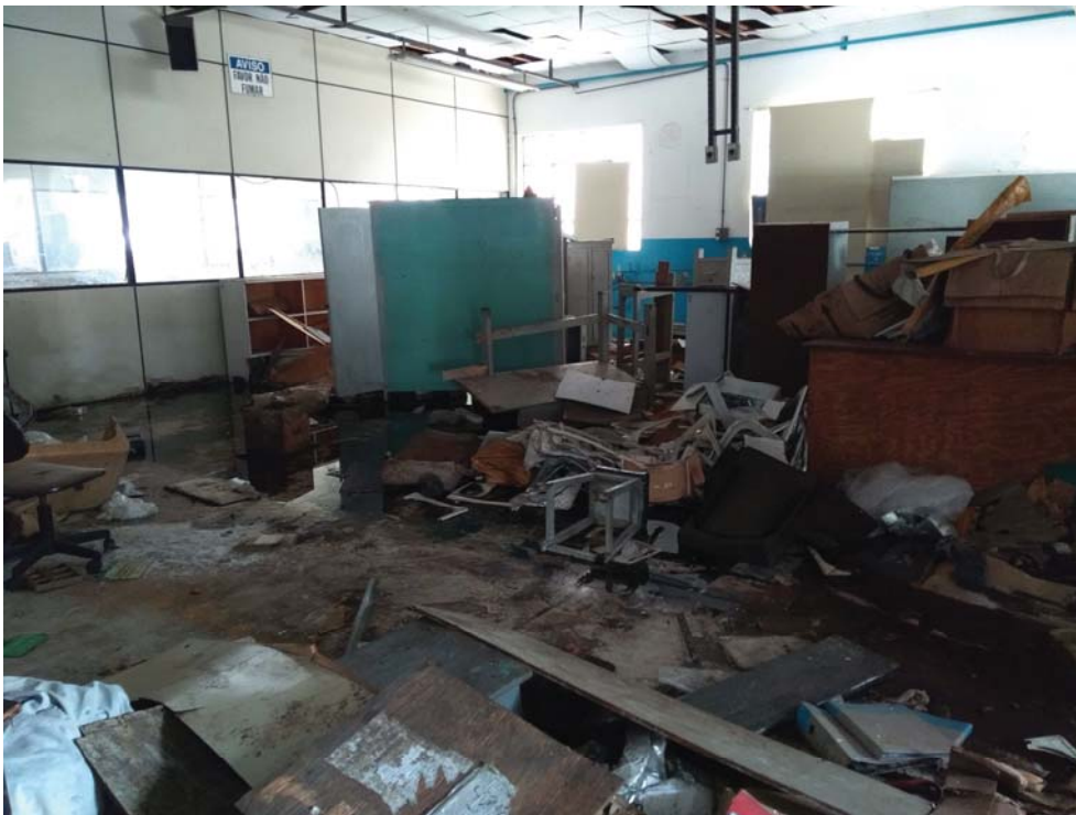
Foto 11 – Parte da oficina do Hangar, com restos de móveis e entulho.
