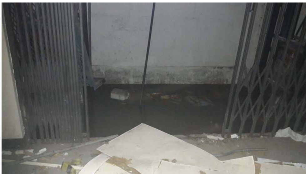
Foto 83 – Fosso do elevador, com água pluvial.
