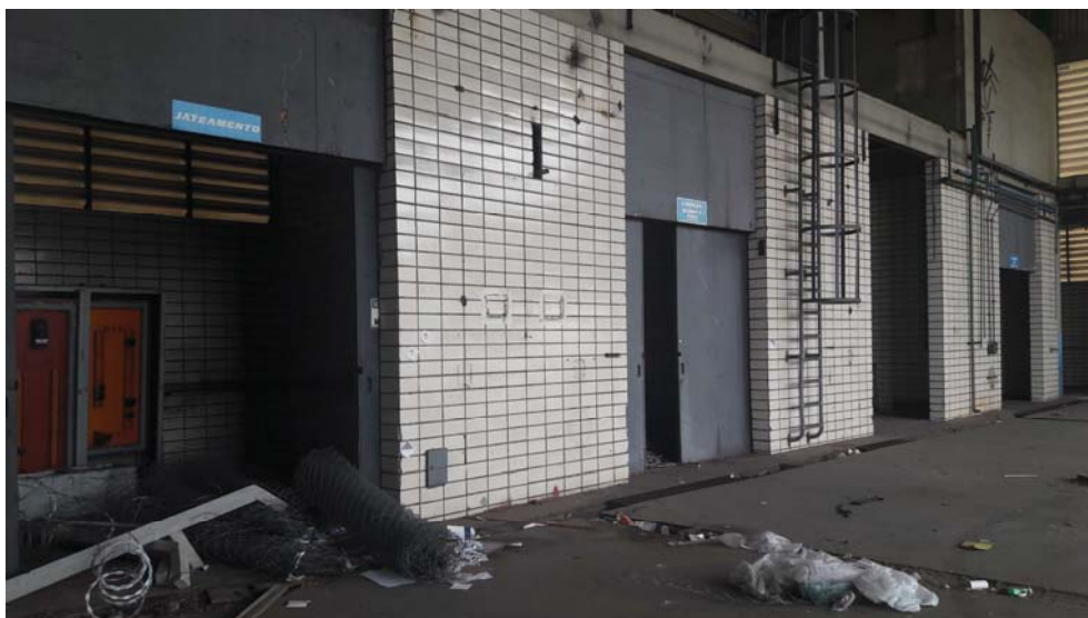
Foto 51 – Setor de jateamento, limpeza química fina e saída de peças.
