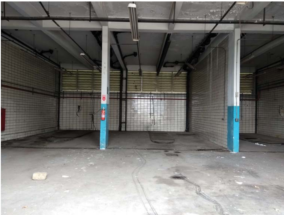
Foto 58 – Vista da área interna da oficina, com manchas no piso.
