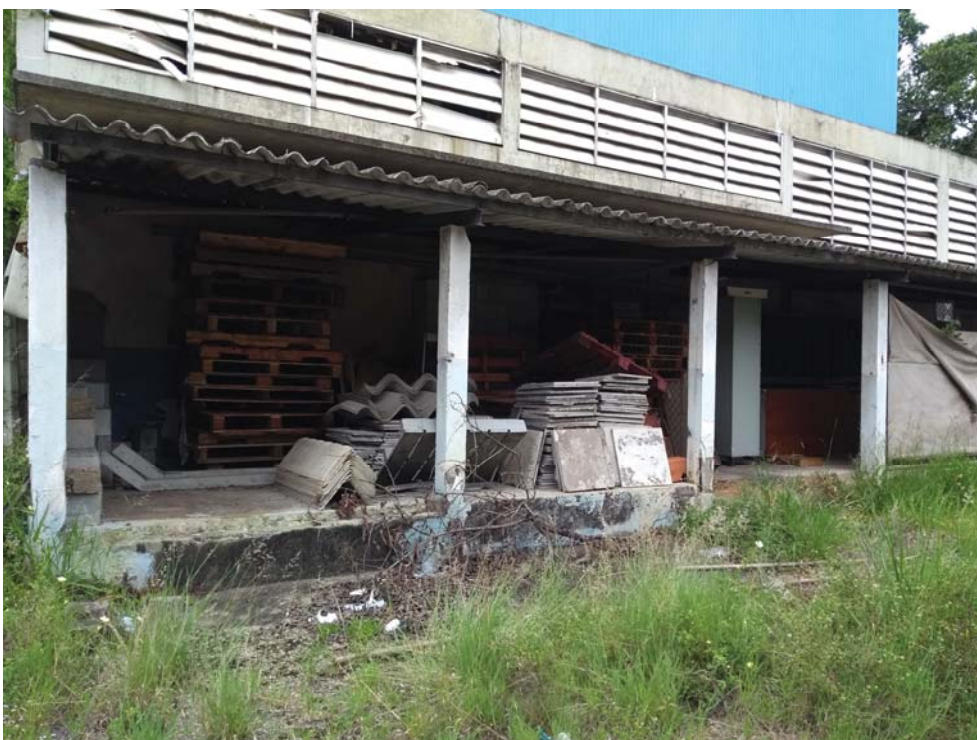
Foto 46 – Área de inflamáveis ao lado da Oficina, onde atualmente são armazenados materiais de construção.
