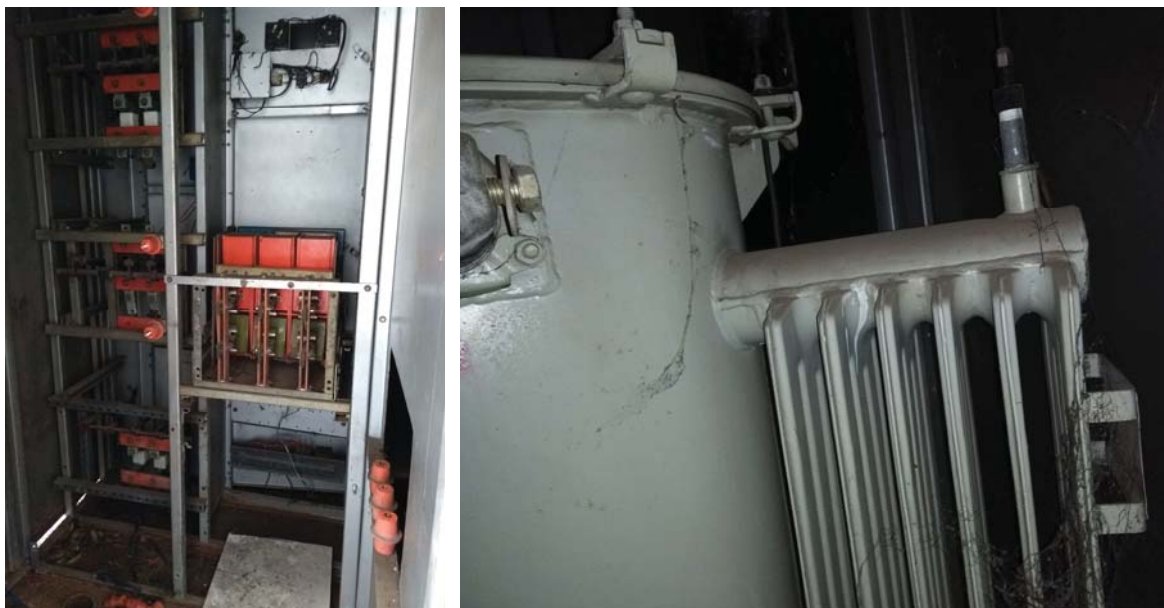
Fotos 36 e 37 – Vista da área interna da cabine primária.
