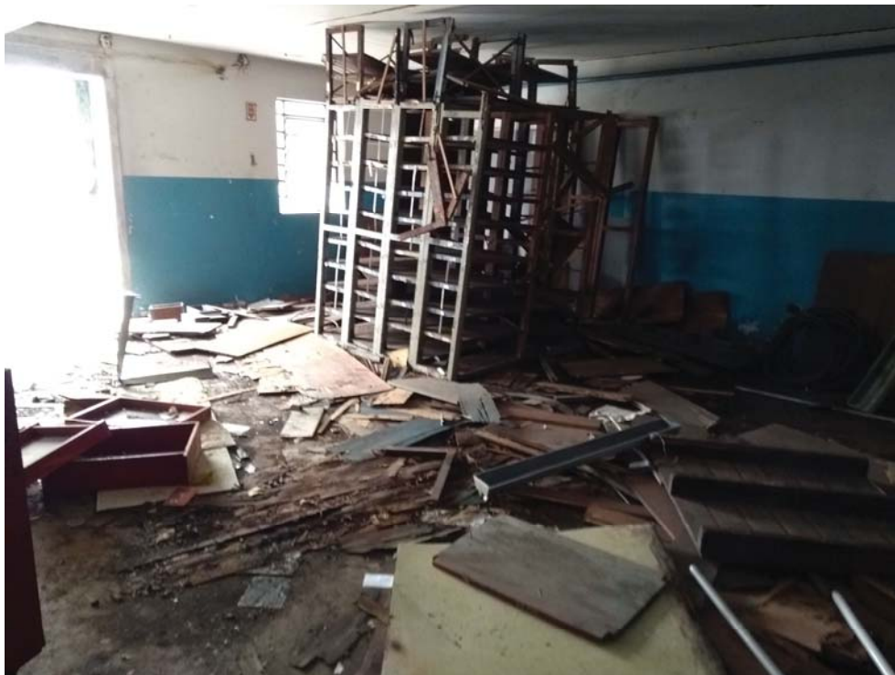
Foto 88 – Uma das salas do setor de tapeçaria, próximo da saída do terreno (guarita), com manchas no piso e restos de móveis e estantes de arquivo.
