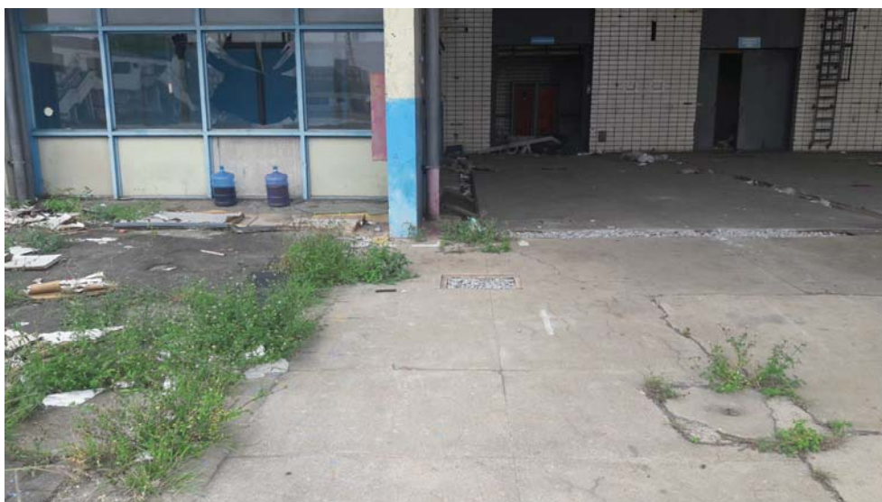
Foto 53 – Rachaduras e vegetação no piso.
