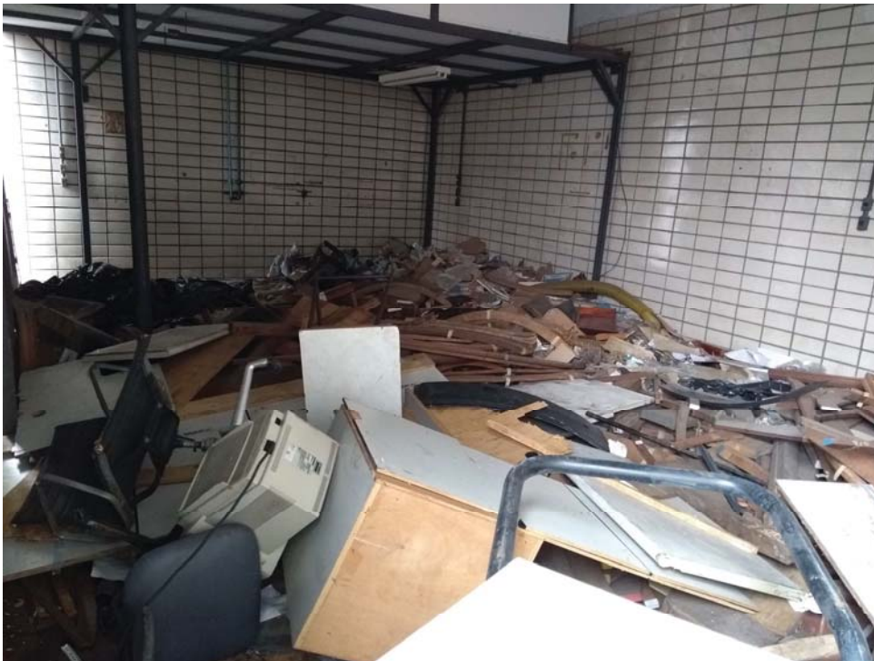
Foto 56 – Entulho entre a oficina mecânica de aviões e de veículos.
