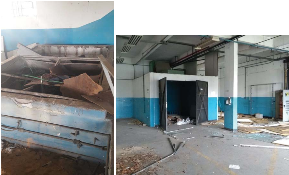
Foto 64 e 65 – Detalhe do tanque e da estufa.
