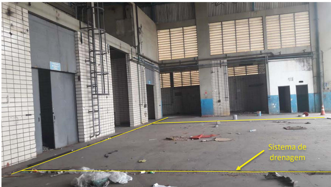
Foto 52 – Vista parcial do sistema de drenagem da Oficina mecânica de aviões (AF-14).
