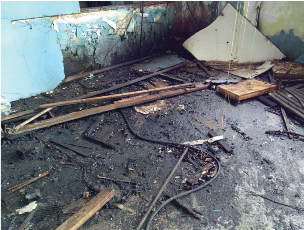
Foto 86 – Manchas de graxa no piso de concreto.
