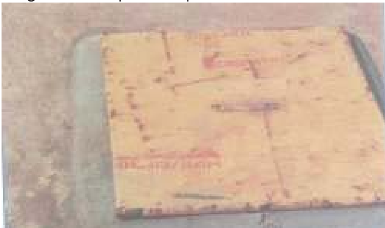
Imagem 11 – Tampa do tanque de descarte de cromato
