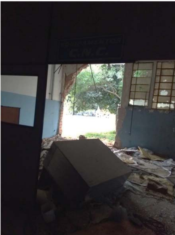
Foto 87 – Setor de equipamentos CNC, com entulho.
