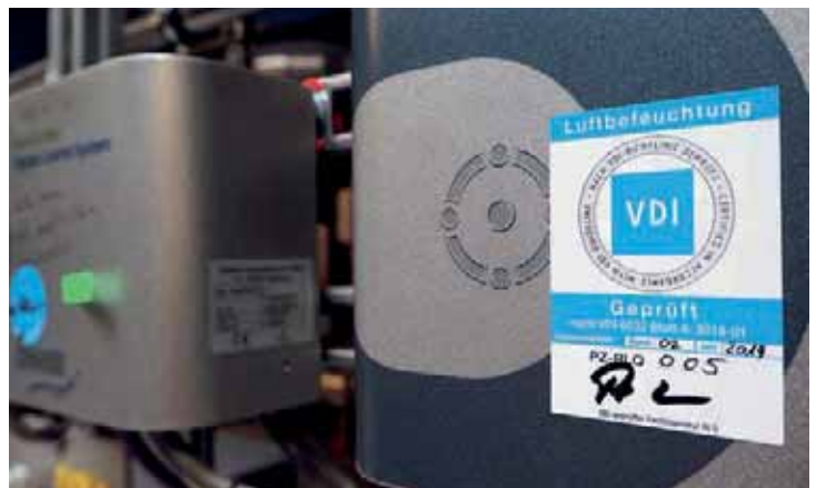
Jährliche Zertifizierungen nach VDI 6022 Blatt 6 dokumentieren den hygienischen Betrieb der Luftbefeuchtung und Wasseraufbereitung.
