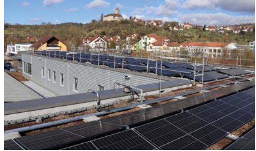
Die neue Photovoltaik-Anlage liefert bis zu zwei Drittel des benötigten Stroms bei MBO.
