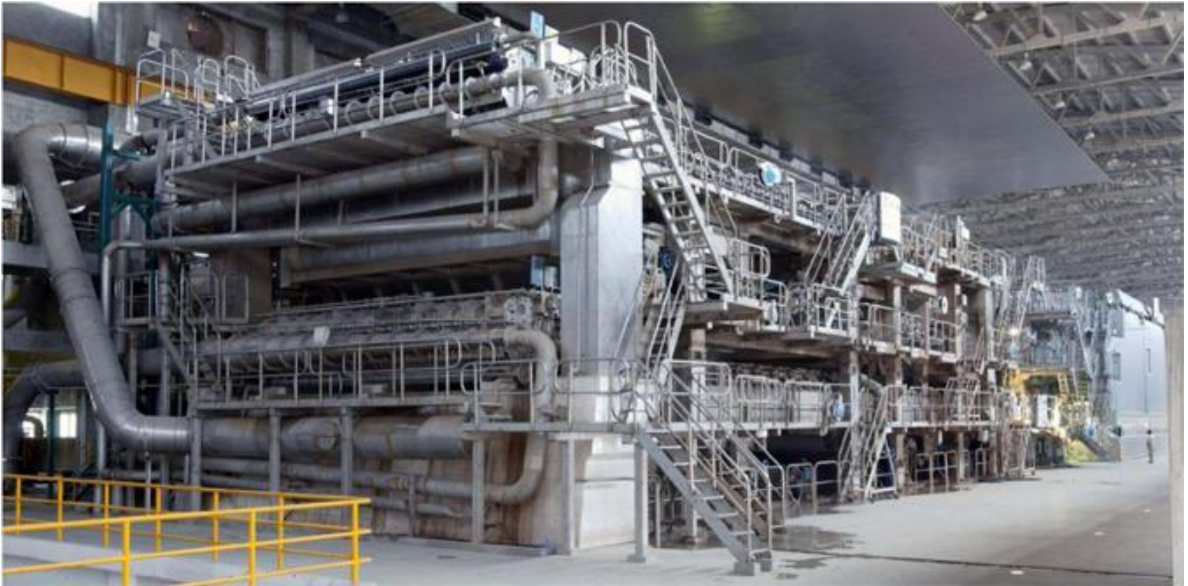
Mehrlangsiebpartie einer Kartonmaschine
