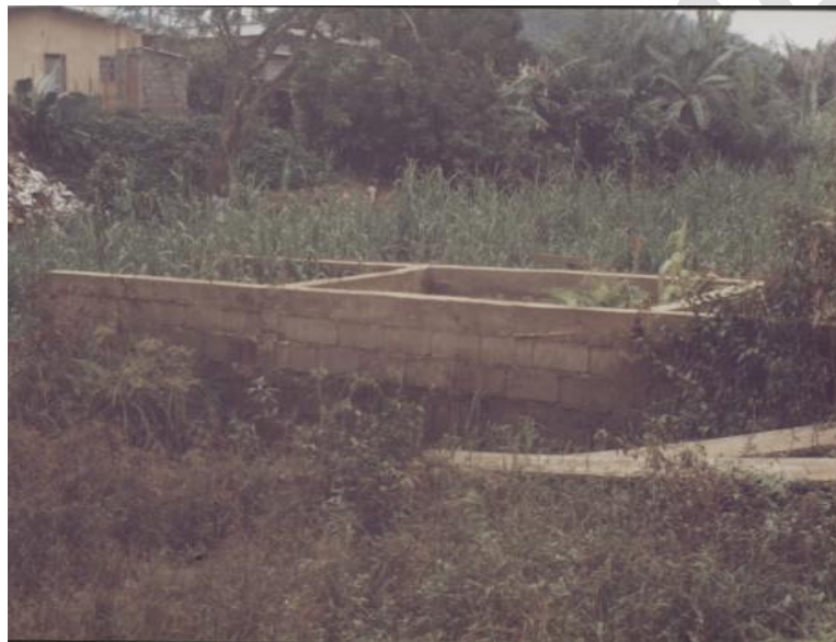
Figure 42 : Construction de maison dans le lit du drain
