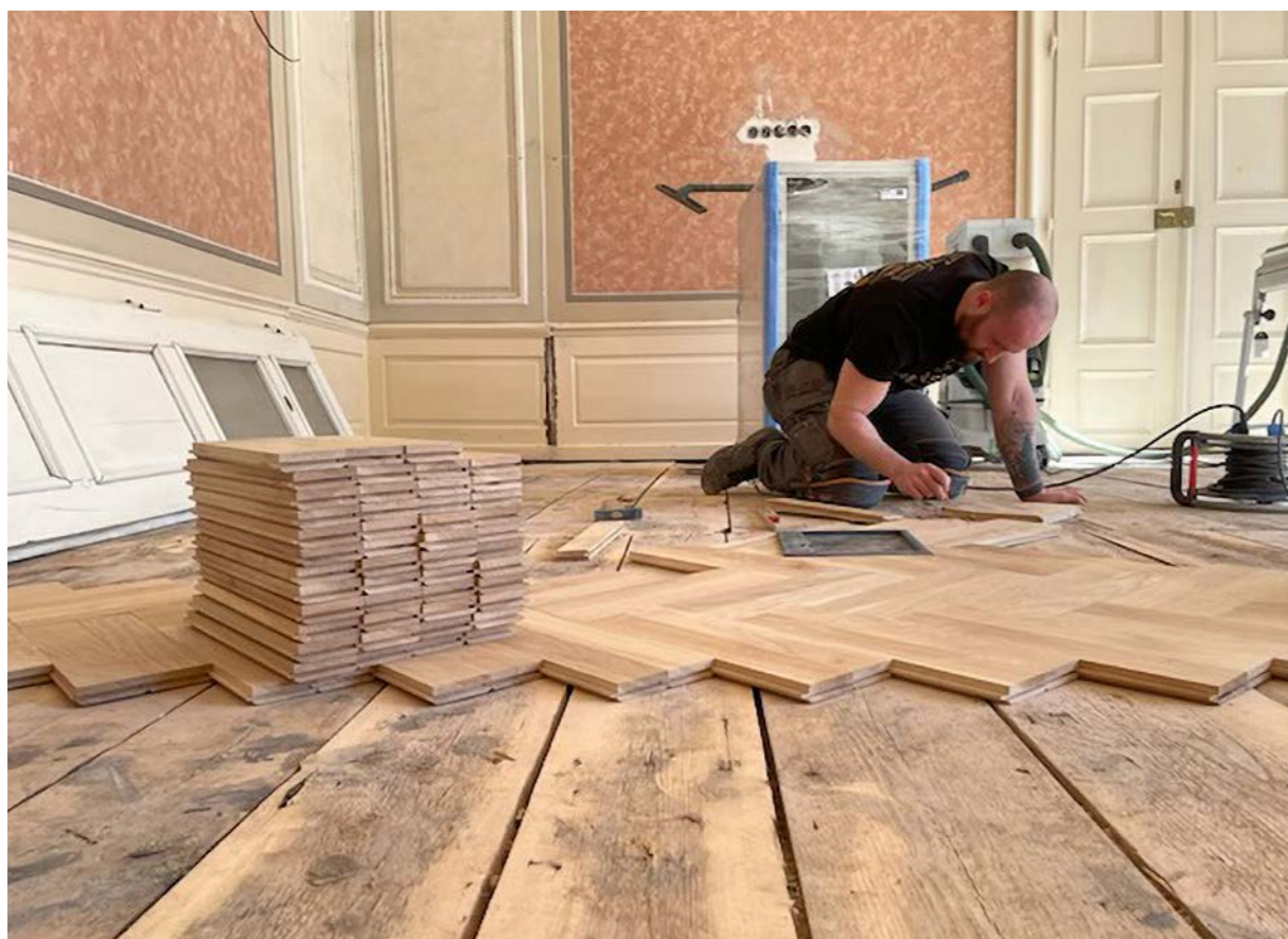
Ledebourský palác, Praha, tradiční pokládka vlysů přitloukáním na původní tesařskou prkennou podlahu.
