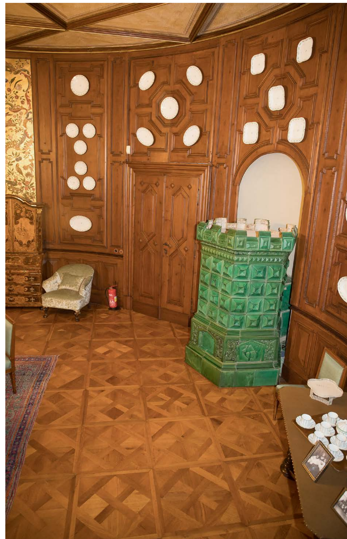
Interiér salonu Černínů na trase Hostinské pokoje státního zámku Hluboká. Parketová podlaha ošetřená metodou broušení a napuštěním olejem. Ve srovnání s interiérem Velké jídelny parkety po této úpravě mají dominantní vzhled a barevně splývají s dřevěným obložením.
