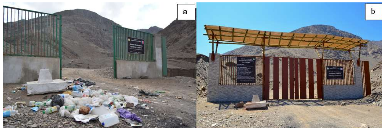
Figura 17: Portón de acceso a la RNLCh: a) Condición previa a reparaciones, b) Condición actual tras habilitación y reparación desarrollada durante junio 2019 por el Proyecto FIC-R Plan de Recuperación RNLCh. Fotografías de Mauricio Mora-Carreño.
