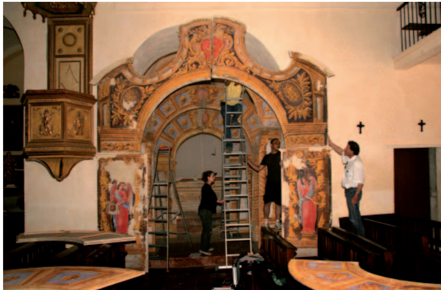
4. Monument de l'église de Finestret (Pyrénées-Orientales), vue d'ensemble, in situ, après restauration, en cours de montage.
