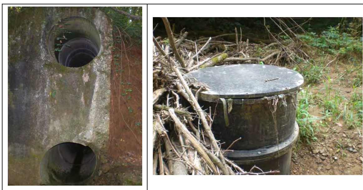
FIGURA 2.11 SCOLMATORE COMUNALE IN SPONDA SINISTRA IDROGRAFICA (A SINISTRA); TORRETTA D'ISPEZIONE DEL COLLETTORE CONSORTILE CON EVIDENTI SEGNI DI FUORIUSCITA DI LIQUAMI DAL CHIUSINO (A DESTRA) (ARCHIVIO CSBA, 2009).
