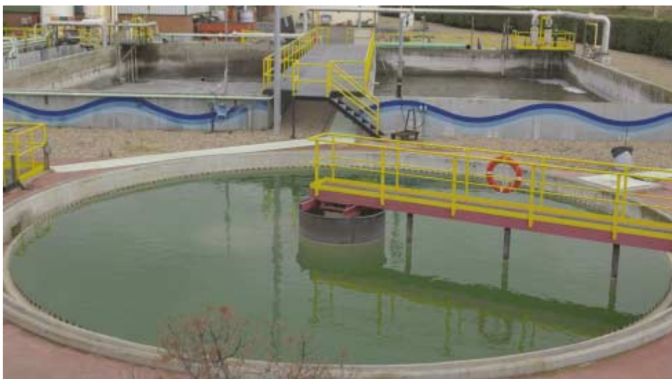
Les sites de production du Groupe sont soigneusement contrôlés afin d'éviter tout risque de pollution. Ici, bassins de décantation de l'usine de Palencia (Espagne).
