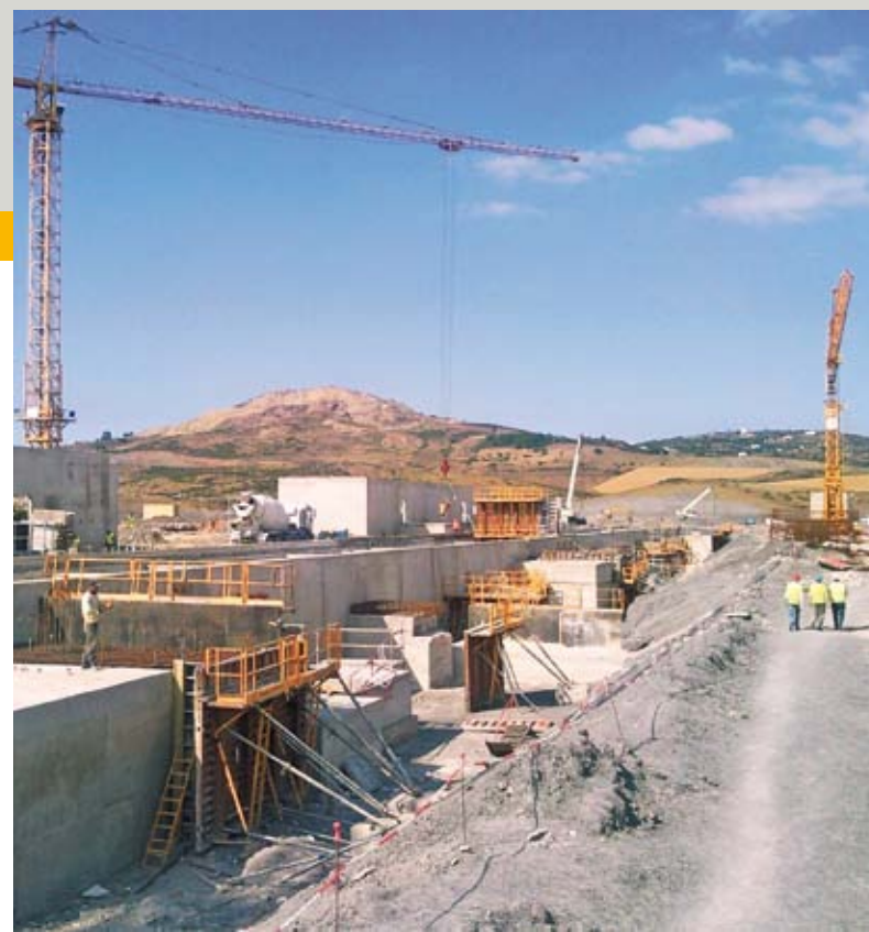
L'usine de Tanger réduira de 35 % ses besoins en énergie thermique.
