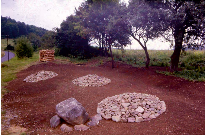
Obr. 9: Kyjatice, okres Rimavská Sobota. Budovanie pamätníka kyjatickej kultúry (Foto: Václav Furmánek). – Kyjatice, district of Rimavská Sobota. Building of the Kyjatice culture monument (Photo: Václav Furmánek).
