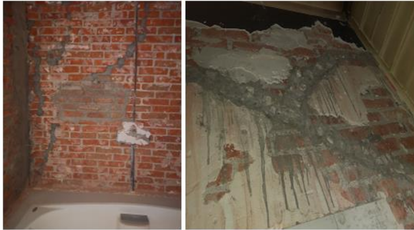
Figura 15. Muro reparado mediante rajuelas, de manera adecuada (izq.) y de manera inadecuada (der.) (Archivo fotográfico proyecto ConTex, 2018).
