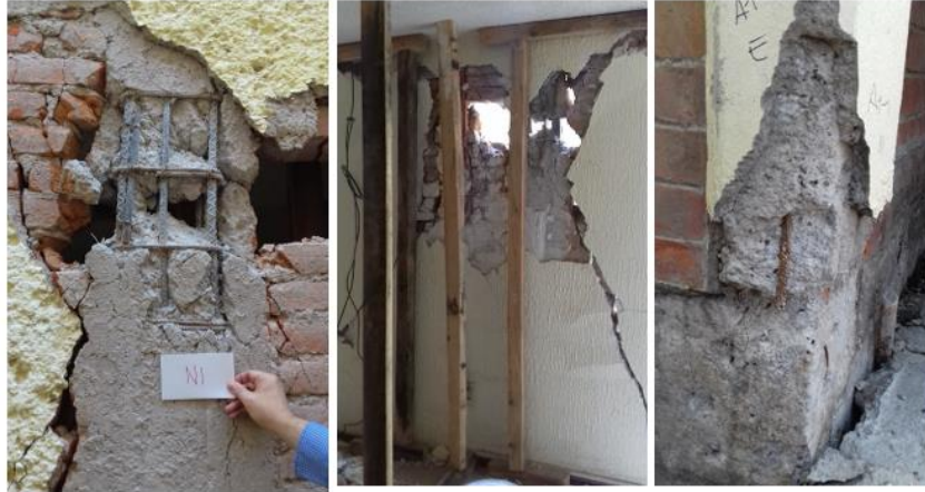
Figura 16. Daños en elementos de confinamiento (Archivo fotográfico proyecto ConTex, 2018).
