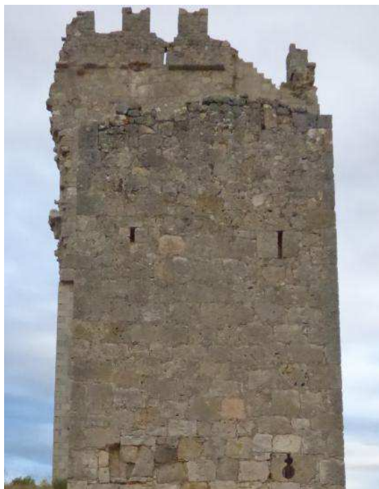
Figura 64. Torre del Castillo de Coruña del Conde en donde se observa su grado de deterioro.
