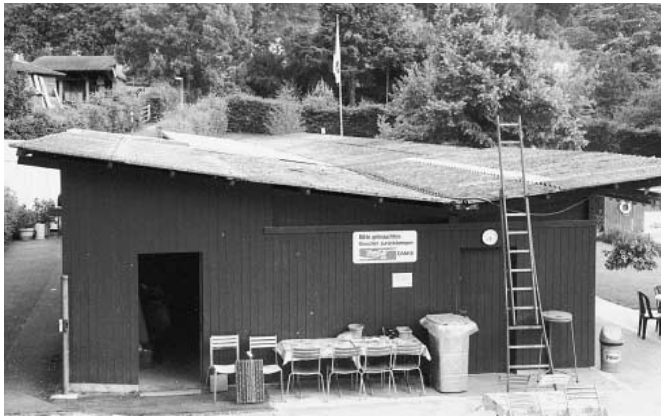
Auf der linken Seite des Daches des Bettinger Gartenbadgebäudes befinden sich die neuen Elemente, die das Wasser für die Duschen der Anlage aufwärmen.
