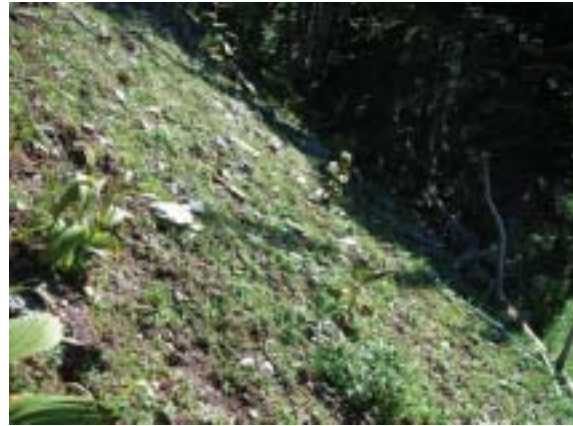
写-155 踏み荒され、石礫が露出した斜面
