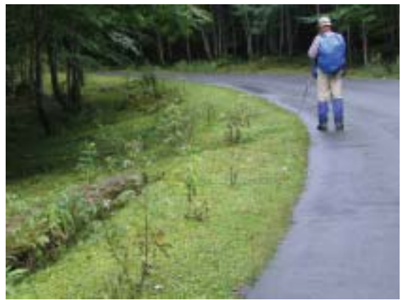
写-77 南アルプス林道の路肩の状況 (以前はホウキアザミが群生していた)
