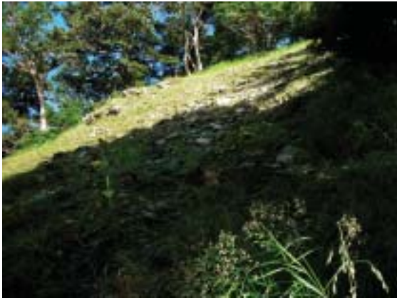
写-154 植生が消滅した斜面
