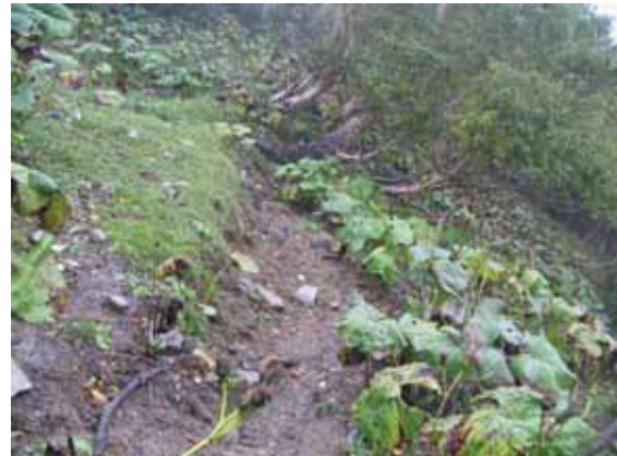
写-69 表土の露出、侵食の危惧
