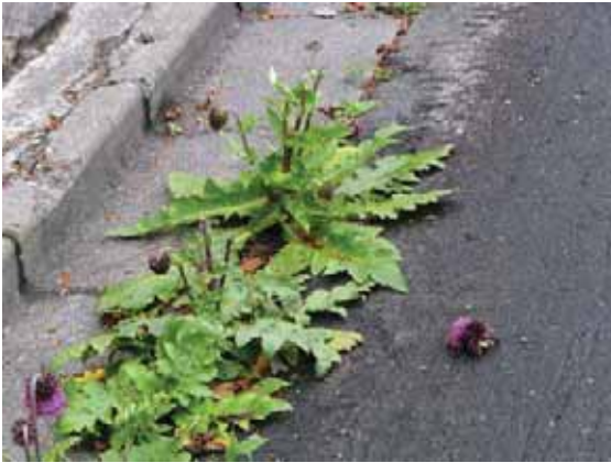
写-74 路肩の植物の被害状況
