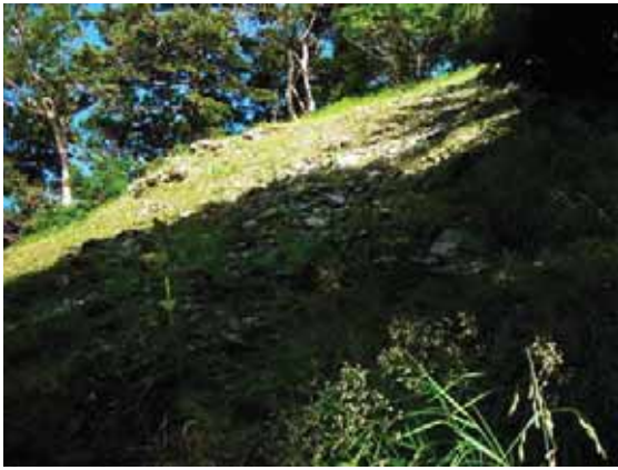
写-154 植生が消滅した斜面
