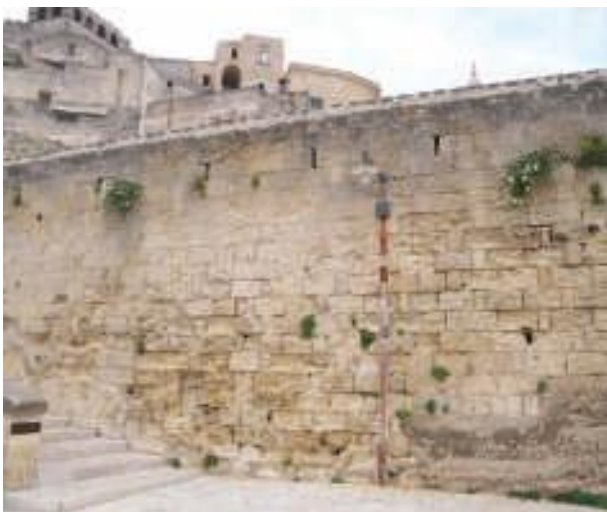
Fig. 6 - Parapetto della via di collegamento tra il Sasso Caveoso e il Sasso Barisano costruito dal Genio Civile nel 1936. Il degrado è molto diffuso e profondo. (foto Di Lena)
