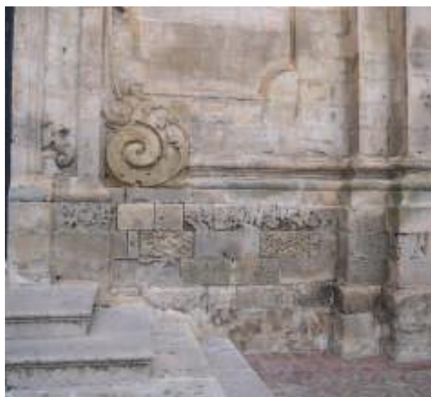
Fig.1 - Particolare del lato destro della facciata della chiesa di S. Francesco d'Assisi, costruita nel 1752. Il degrado interessa solo la base, in particolare la malta della muratura è quasi scomparsa. Alcuni conci sono stati sostituiti a cucì e scuci (foto Di Lena)
