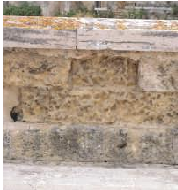
Fig.5- Una parete in via Sant'Angelo nel Sasso Caveoso. Il degrado dovuto all'evaporazione dell'acqua di umidità è molto profondo e diffuso. Minaccia il crollo della parete. (foto Di Lena)
