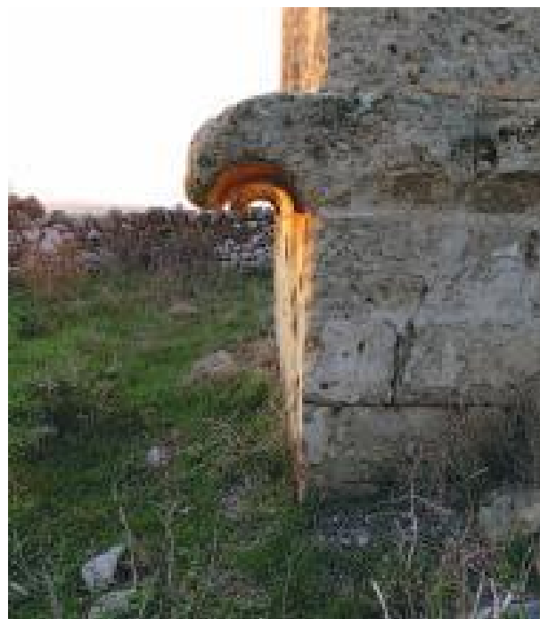
Fig. 5 - Cordolo perimetrale anti intrusione. Colombaia di Masseria Fornello, Altamura (foto R. Paolicelli)
