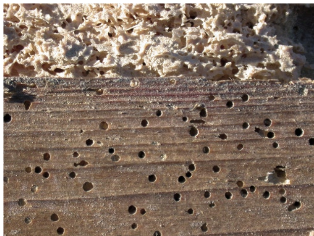
FIGURA 26 Orificios de emergencia y galerías de Anobium punctatum .
