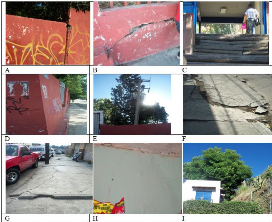
Figura 6 Evidencias de daños por actividad geológica reciente. A) Bardas disperejas por presión ejercida por el talud en la Secundaria #77; B) Cuarteaduras en la barda de la misma institución; C) Escaleras dañadas en la Secundaria; D) Bardas de la Secundaria deformes por la presión de la falla; E) Poste de electricidad inclinado en la misma Secundaria; F) Grietas en la carpeta asfáltica de la calle Ahuizotl; G) Banquetas deformadas con grietas paralelas al eje de la Falla, en la misma calle cerca de un paradero de transporte público; H) Daños en las paredes de una casa habitación presuntamente recientes por actividad sísmica; I) Pared del talud del escarpe de la Paloma peligrosamente cercano a una casa habitación en la colonia Ocolusen.
