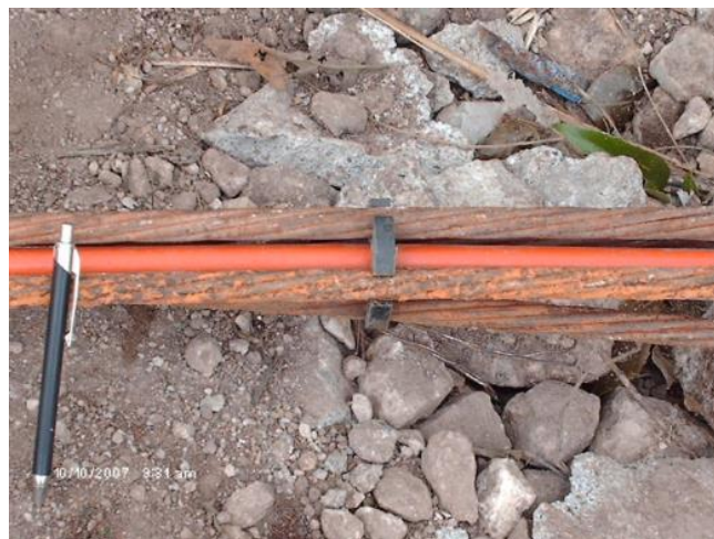
Figura 2.- Paquete de cuatro torones que constituyeron el alma del ancla para estabilización de talud en residencia del Fraccionamiento Club Campestre de Morelia.
