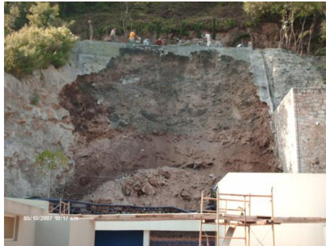
Figura 1 Desprendimiento de bloques de rocas y detritos en talud de residencia en el Fraccionamiento Club Campestre de Morelia, Ocurrido en Septiembre del 2007.
