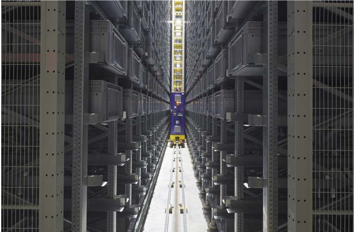
Afbeelding 4 Het ASRS-magazijn van de Kooperative Speicherbibliothek Schweiz. Foto: Ulrich Niederer
