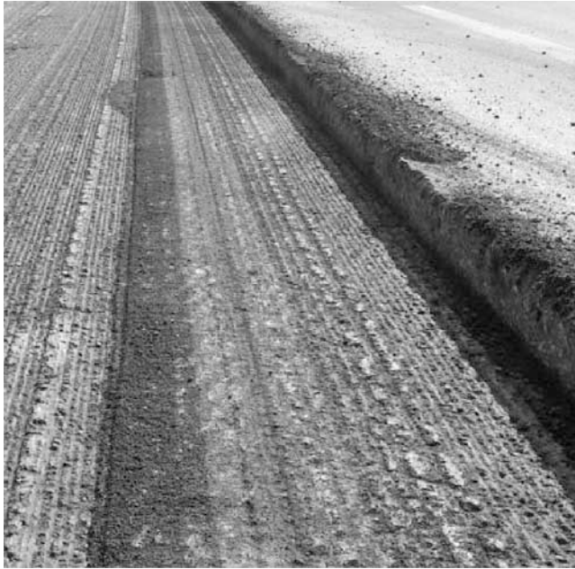
Figura 6. Ejemplo de reparación previa: fresado. (Rasmussen y Rozychi, 2004)
