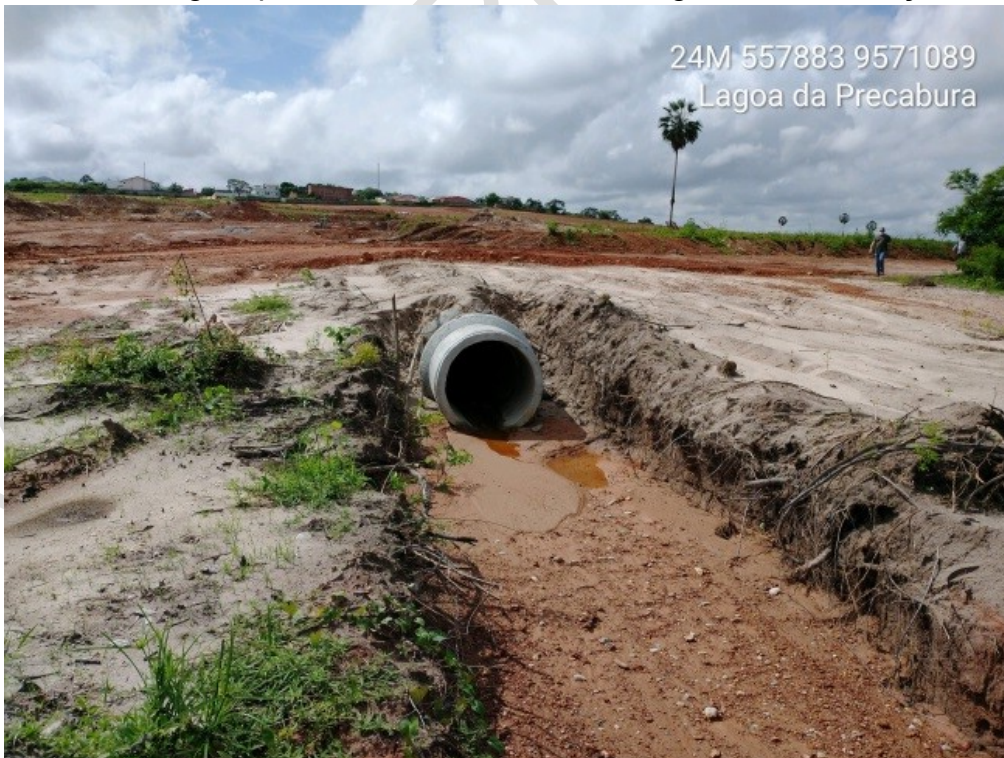
Figura 88 – Drenagem pluvial em Loteamento à margem do Rio Coaçu.
