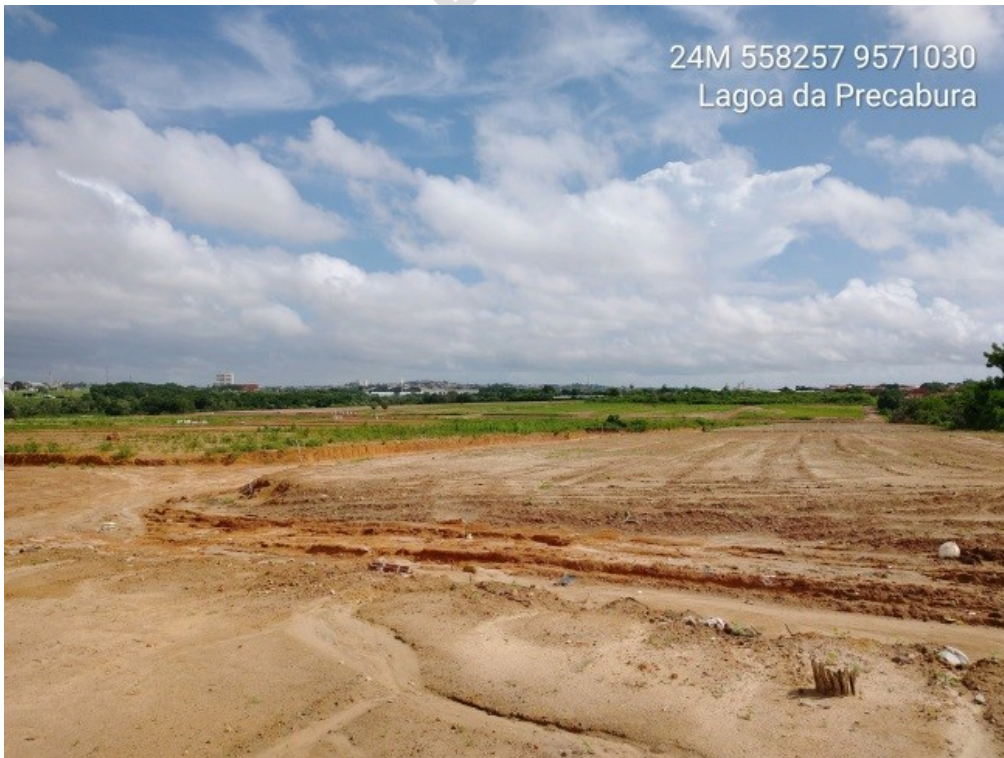
Figura 86 – Loteamento à margem do Rio Coaçu, a montante da Lagoa da Precabura.
