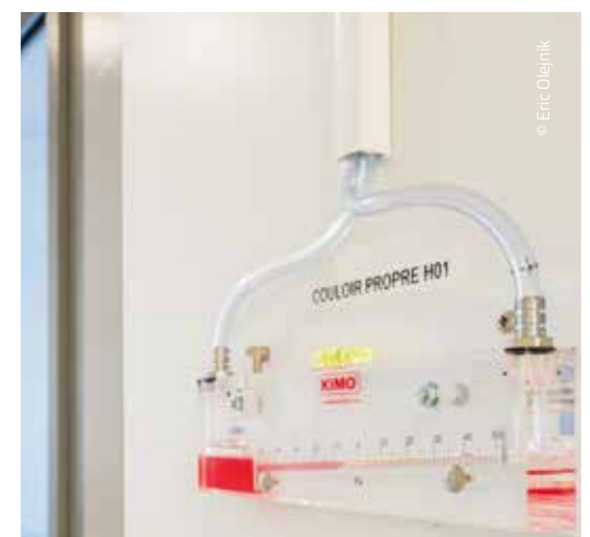
Des manomètres sont présents dans les couloirs de l'entreprise afin de mesurer la pression.
