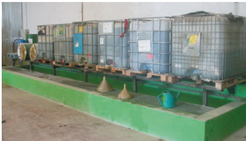
Ilustración 61 Cubeto de retención de residuos líquidos
