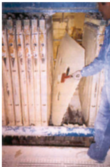
Ilustración 11 Filtro prensa en funcionamiento
