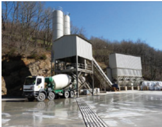
Ilustración 22 Planta de hormigon
