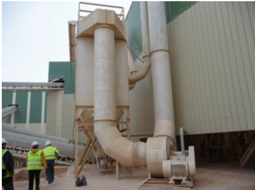
Ilustración 54 Detalle filtros de mangas
