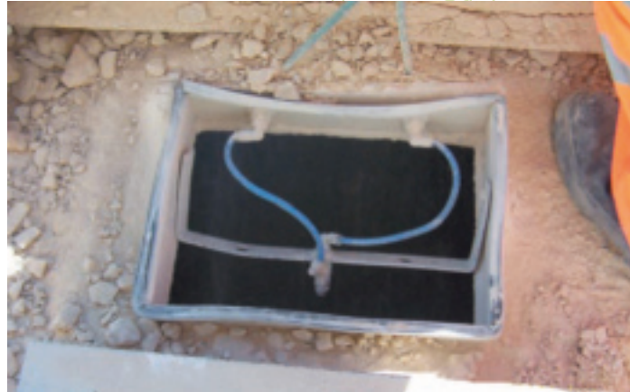
Ilustración 45 Sistema de eliminación de polvo mediante cámaras de niebla, en el circuito de trituración primaria compuesto por una mezcla de agua y aire comprimido
