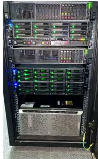
Figura 1. Rack servidores instalaciones Instituto SINCHI
