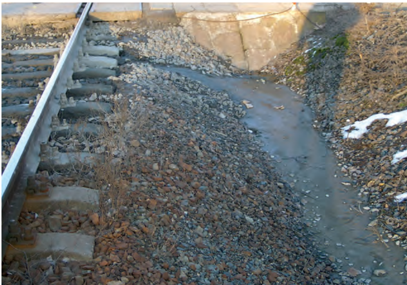
6. ábra. Sárfolyás aszfalt kiegészítő réteggel erősített szakaszon
