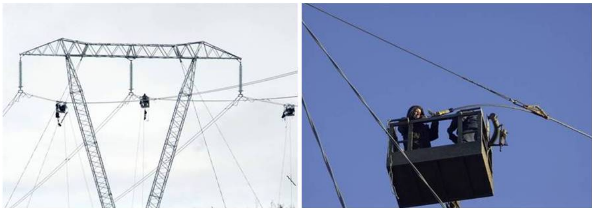
Mynd 2.40 Vinstra megin sést hvar unnið við uppsetningu sparra og hægri megin þegar endaklemmu komið fyrir á leiðara.
