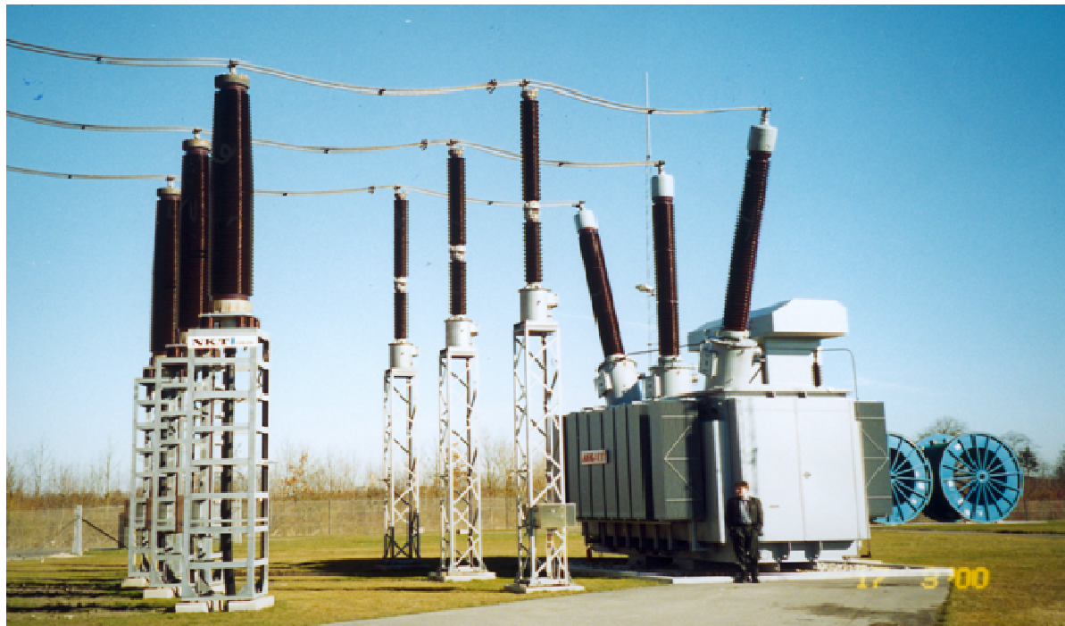
Mynd 2.3 400 kV launaflsjöfnunarstöð
