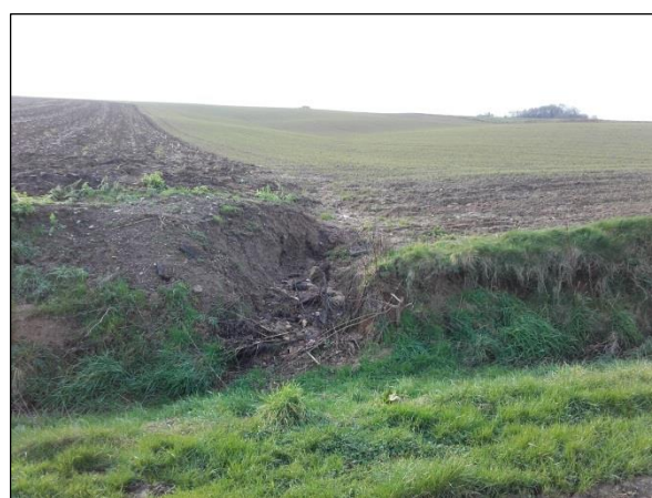
Talus raviné le long de la RD193
