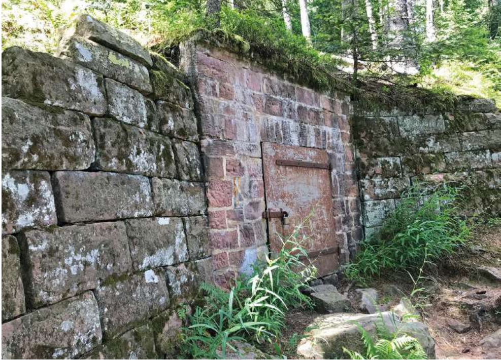
Abbildung 8: Die Mauern des kleinen Pumpwerks am Abstieg zum See sind mit Krustenflechten bewachsen, darunter Verrucaria muralis in den mörtelhaltigen Mauerfugen (auf Bild nicht erkennbar) und Flechten der Gattung Lepraria , erkennbar als weiße Flecken (z. T. L. eburnea ). Foto: M. SCHOLLER
