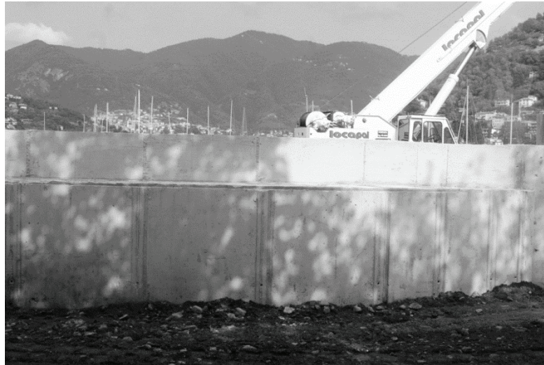
Fig. I - Il muro sul lungo lago di Como nel 2009.
