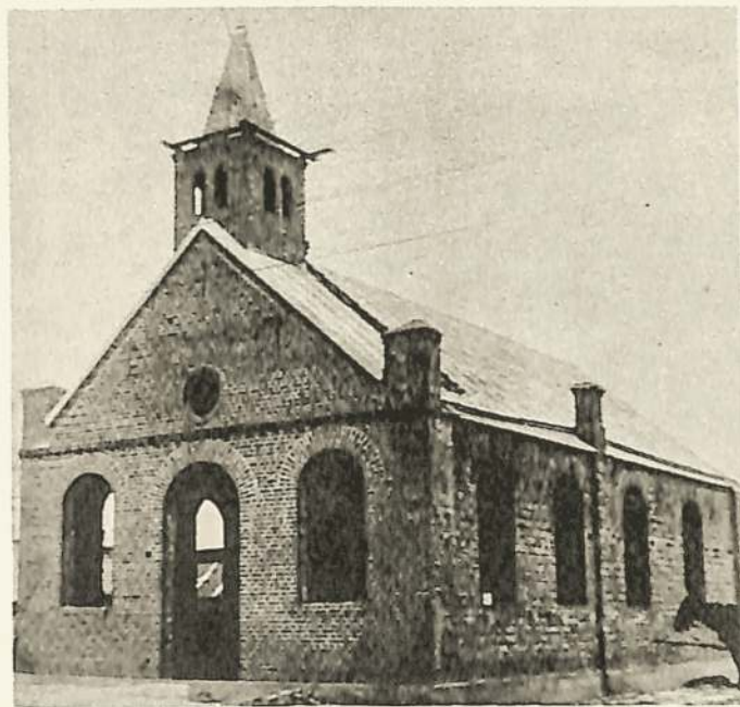
Pilviškių mieste, Vilkaviškio apskr., liet. ev. liuteronų bažnyčia statybos metu 1928 m. Lietuvos okupantai šioje bažnyčioje įrengė kino teatrą
