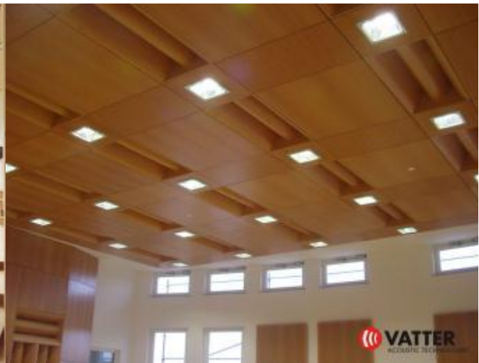
Abb. 71: Akustikdecke mit Parabolic Wave Diffusoren [VATTER, 2011]
