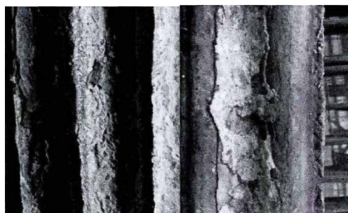
图1 燃煤电厂锅炉水冷壁高温腐蚀 [4]
