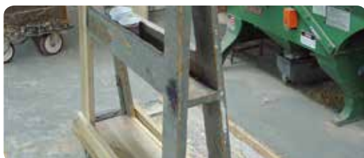
Holz – splittert und fault
