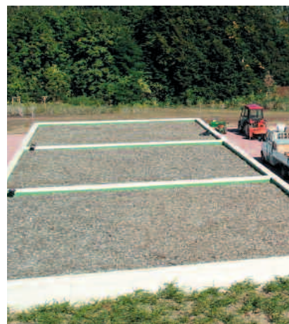
Die Abluft geruchsbelasteter Anlagenteile wird biologisch gereinigt.
