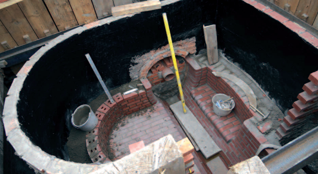
Die meisten Schächte werden heute aus Beton-Fertigteilen errichtet. Bei großen Kanälen und besonderen örtlichen Verhältnissen werden aber auch gemauerte Einsteigschächte errichtet.
