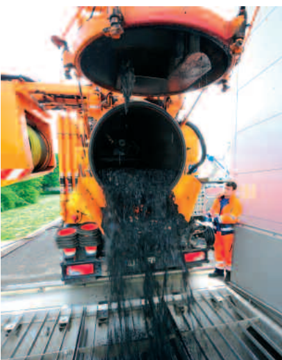
Filterung und Wiederverwertung von Abwasser im Hochdruckspül- und Saugfahrzeug
