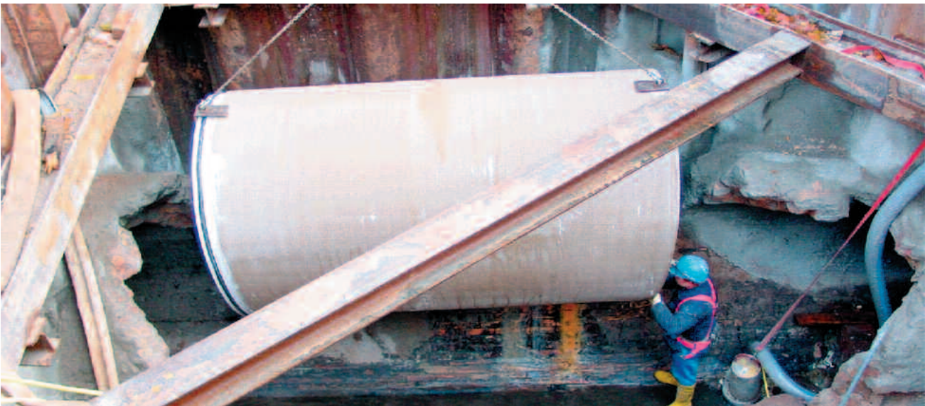
Das GFK-Rohr wird in die Baugrube eingehoben, auf dem Einziehschlitten befestigt und in den alten Kanal eingezogen.
