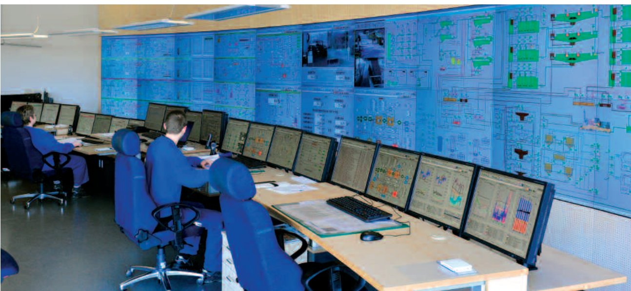
Die Leitwarte dient der Überwachung und Steuerung der ARA und SEVA Sindlingen.
